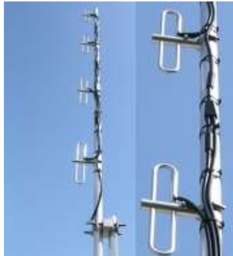
Φωτογραφία 4: Φωτογραφίες της κεραίας ΥΗFτου αναμεταδότη DMR με τα 4 δίπολα
